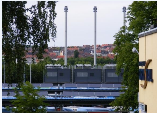
PV-Anlagen und BHKW's Busdepot, Saarbrücken (Projektplanung und -steuerung, Bau, SiGeKo)
